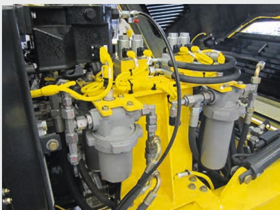
Сторона нагнетания системы фильтров гидравлики.
